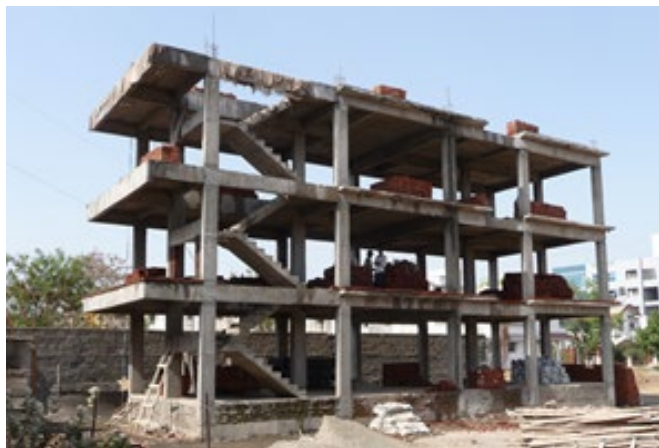
Imaj 2. Planch beton ame yo nan bilding sa a mare kolòn ak travès yo ansanm epi fòse tout pati sa yo deplase ansanm orizantalman pandan yon tranbleman tè.
