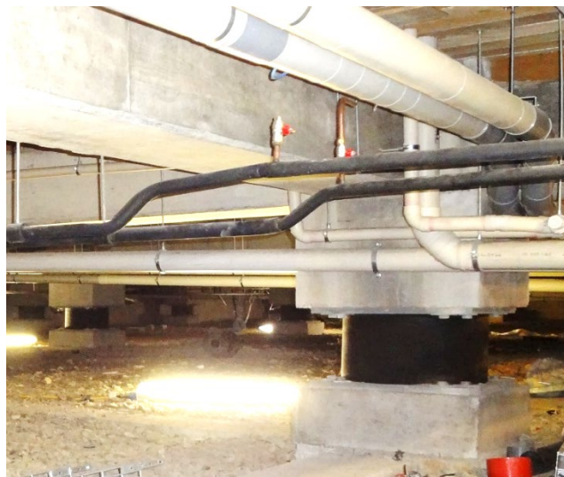
Imaj 2. De sipò izolasyon silendrik nwa anba yon bilding. Chak sipò boulonnen sou yon baz an beton ki kole ak fondasyon an epi ak baz yon poto ki monte nan bilding nan.
