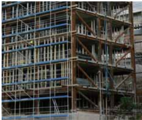
图 3-4 钢框架-支撑结构抵抗作用在建筑宽度方向上的地震力，钢框架沿建筑长度方向提供强度
