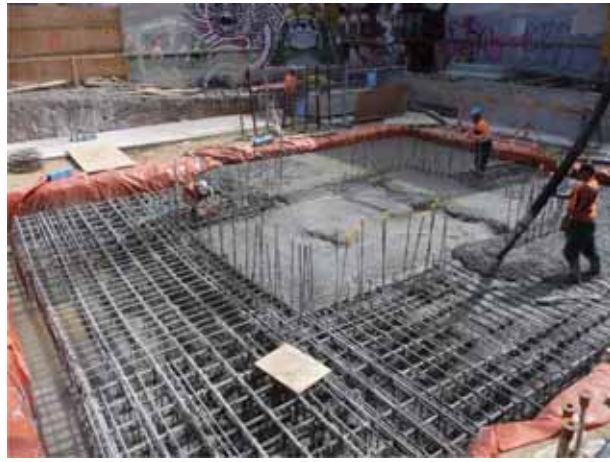
图 16-3 正在施工的基础。工程师已按照规范确定钢筋的数量及其位置
