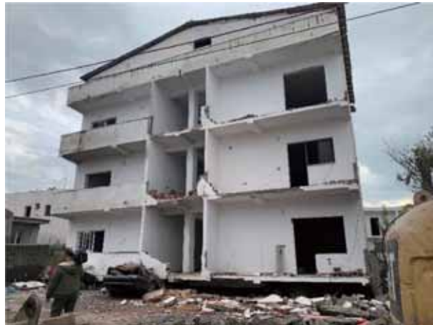
图 11-4 建筑的底层薄弱层在一次地震中倒塌 (N. Vesho)
