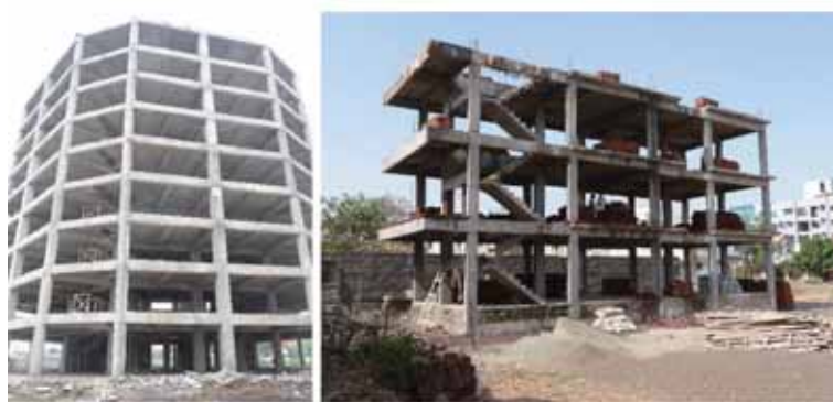
图 6-1 两座建筑通过柱和梁抵抗地震，外围护墙和内隔墙尚未建造
