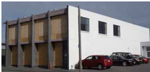
图 4-1 一座震损建筑。沿白色砖墙的方向具有较高的强度和刚度，避免了地震时的损坏。在房屋宽度方向具有较小的刚度，地震时产生较大的晃动造成了房屋的损坏。损坏部位暂时用胶合板覆盖
