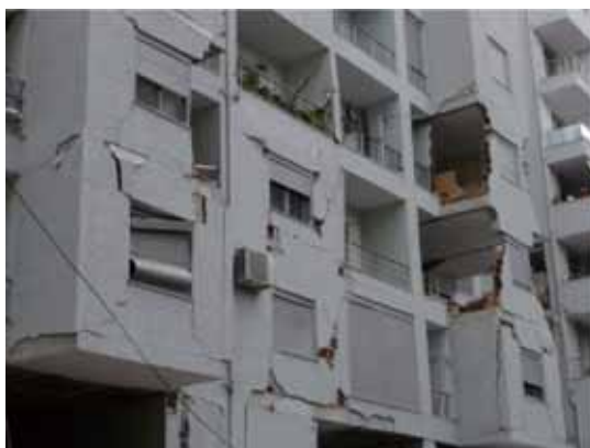
图 10-2 地震时损坏的填充墙，有些已经从建筑上掉了下来
