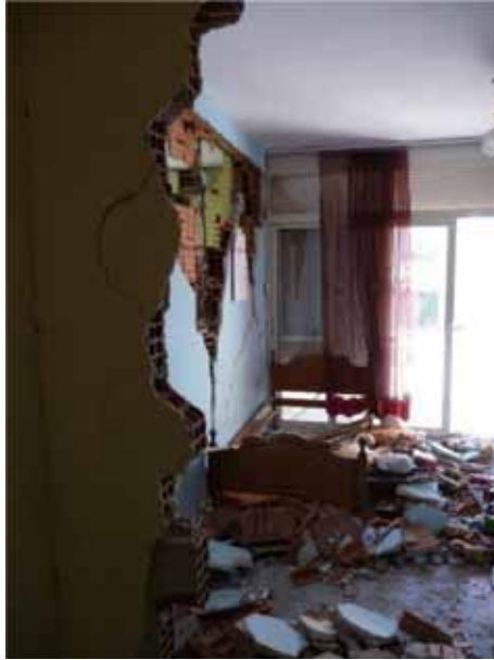
图 21-2 地震震动导致的隔墙破坏会危及生命
