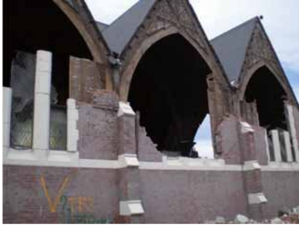
图 21-4 地震摧毁了这个建筑的大部分砖石外墙和玻璃
