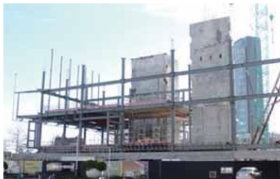
图 4-3 正在建设中的大楼。两个方向的大部分地震力都由钢筋混凝土剪力墙抵抗。在这种情况下，周边钢框架也提供了一些帮助
