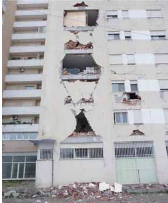
图 18-2 地震损坏建筑的示例，其中填充墙没有经过抗震设计以承受地震期间的力和位移
