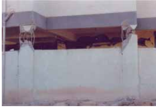
图 13-4 地震损坏的短柱
