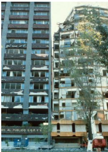
Gambar 2. Dua bangunan saling berbenturan, dimana salah satu bangunan mengalami kerusakan yang lebih parah daripada bangunan lainnya.
