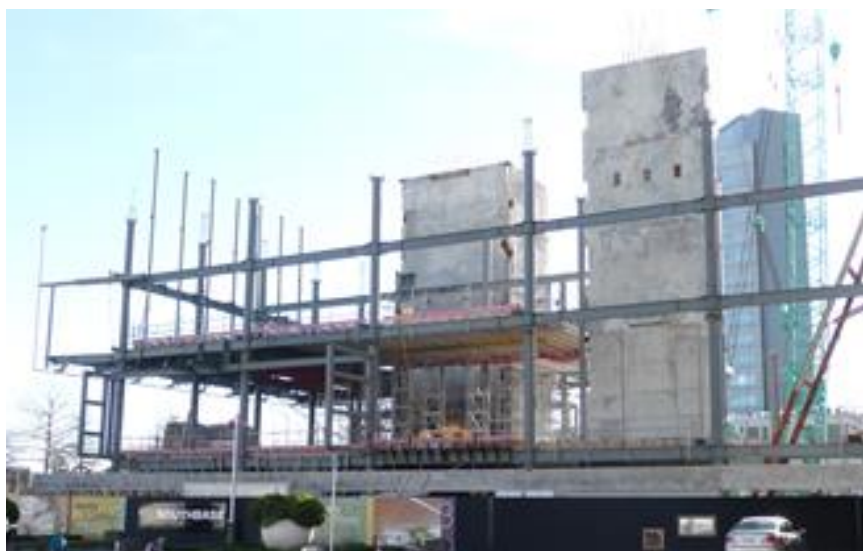
Gambar 3. Bangunan yang sedang dibangun. Sebagian besar gaya gempa di kedua arah ditahan oleh dinding struktural beton bertulang. Pada kasus ini, rangka momen baja di sekeliling bangunan juga ikut menahan gaya gempa. 3
