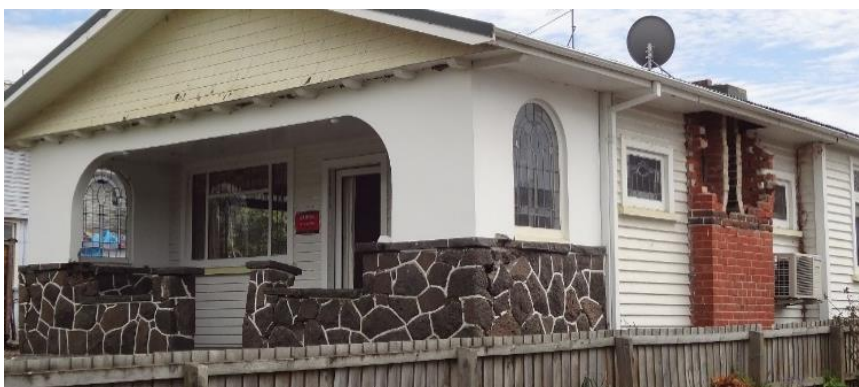
Gambar 3. Cerobong asap pasangan bata di atap terlepas dan jatuh. Sisanya mengalami kerusakan (N. Allaf).
