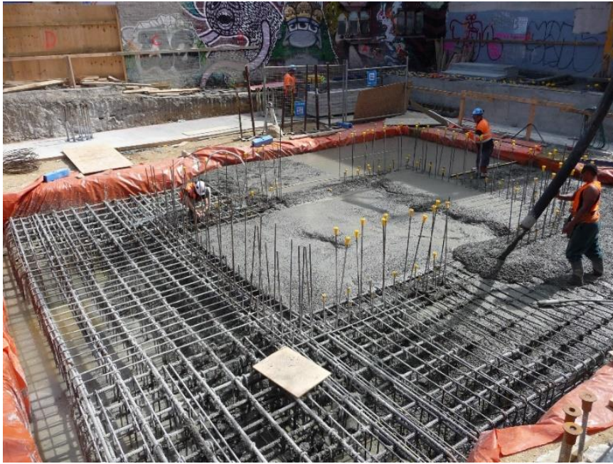
Gambar 3. Fondasi bangunan yang sedang dibangun. Insinyur harus mengikuti peraturan untuk menentukan jumlah baja tulangan serta lokasinya yang benar.
