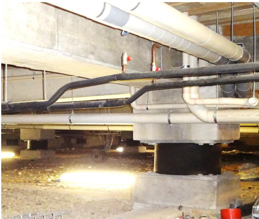
Gambar 2. Dua pengisolasi dasar berbentuk silinder dan berwarna hitam di bawah bangunan. Setiap bantalan dibaut ke dasar beton yang melekat pada fondasi dan ke dasar kolom yang menjulang ke atas bangunan.
