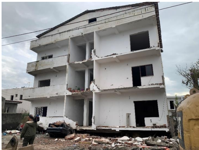
Gambar 4. Bangunan bertingkat lunak ini kehilangan lantai dasarnya akibat gempa (N. Vesho).
