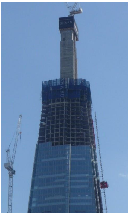
Gambar 3. Contoh bangunan beton bertulang yang sedang dibangun dan tampak struktur inti berupa dinding geser.
