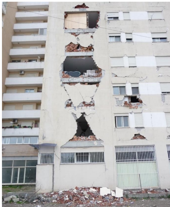
Gambar 2. Contoh bangunan yang rusak akibat gempa dimana dinding pengisi tidak dirancang dengan baik untuk menerima gaya dan gerakan gempa.
