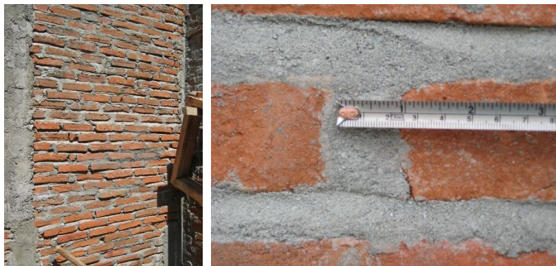
Gambar 4. Konstruksi pasangan dinding bata yang kurang baik, dimana bata tidak tersusun rapi dan mortar yang mengisi ruang di antara bata terlalu tebal.
