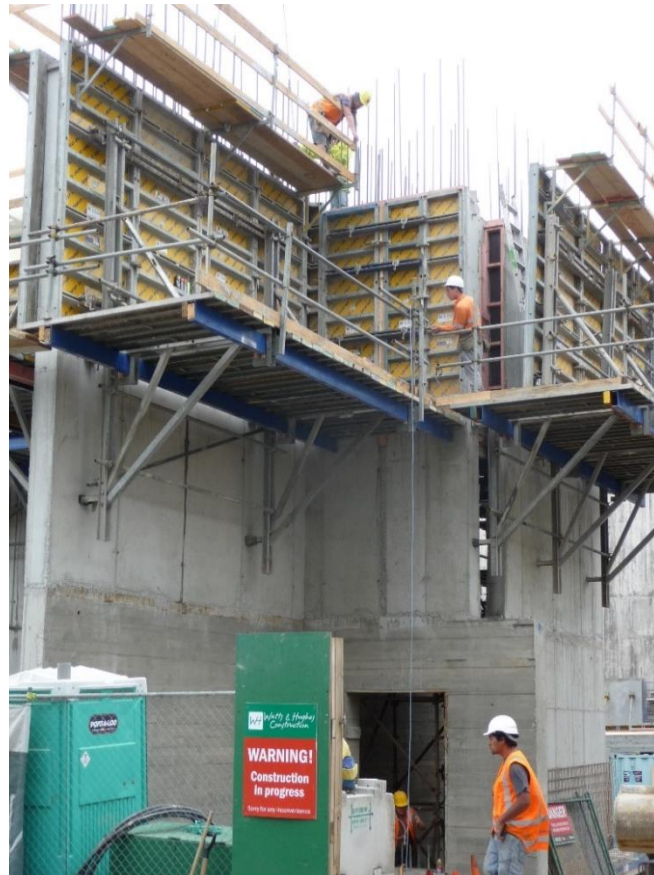
Gambar 2. Selama perancangan dan pelaksanaan konstruksi, dinding beton bertulang ini diperiksa untuk memastikan rancangannya benar dan pelaksanaannya sesuai dengan rencana.
