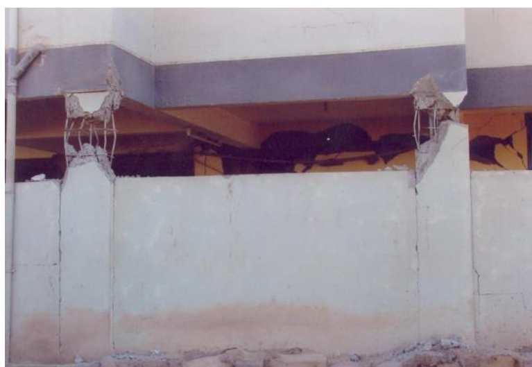
Figure 1. Kerusakan pada kolom pendek akibat gempa
