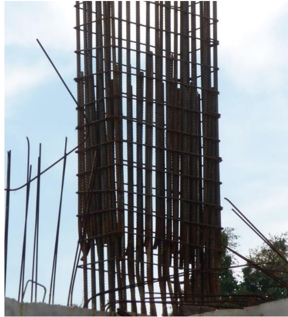
Gambar 2. Penulangan pada kolom ini melanggar banyak sekali ketentuan peraturan dan standar bangunan. Kolom ini dapat rusak parah saat gempa
