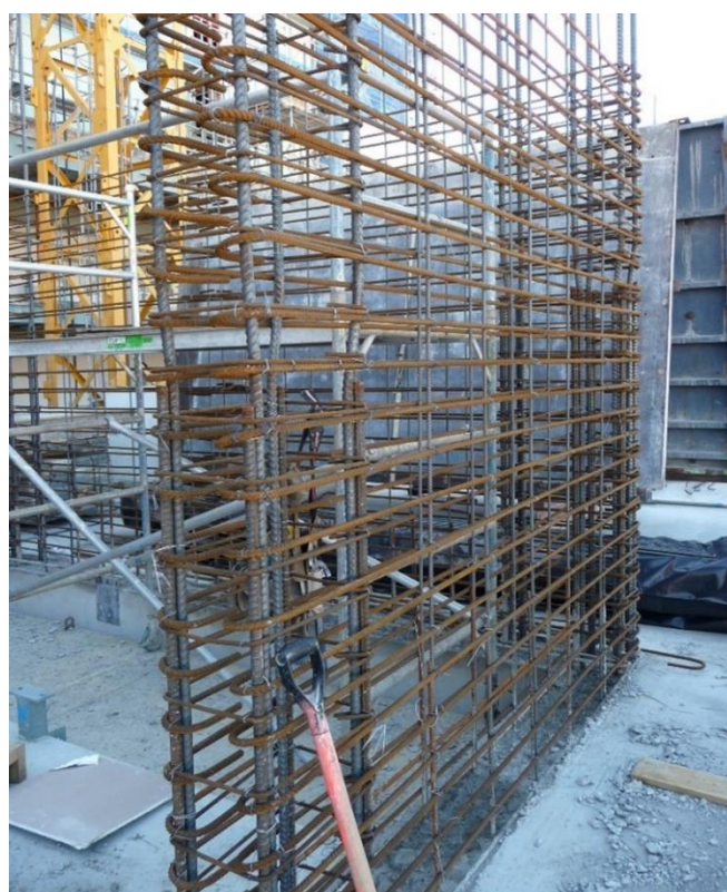
Gambar 1. Kerusakan parah ketika gempa dapat terjadi pada dinding beton bertulang jika sejumlah tulangan tidak terpasang.
