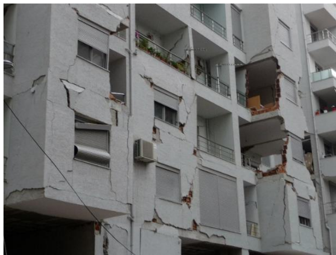
Gambar 2. Dinding pengisi yang rusak akibat gempa, beberapa di antaranya telah jatuh dari bangunan.
