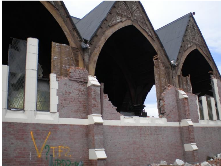
Gambar 4. Gempa menghancurkan sebagian besar cladding bata dan kaca bangunan
