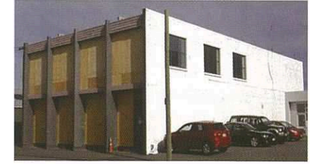
চিত্র ১. একটি ভূমিকম্প ক্ষতিগ্রস্ত ভবন। এই ইটের তৈরি সাদা দেয়ালের সবলতা এবং দৃঢ়তা ভবনটিকে ক্ষতির হাত থেকে রক্ষা করে। ভবনের সামনের বহির্ভাগে ক্ষতির কারণ হচ্ছে গোটা ভবনে ব্যবহারকৃত লগবগে কাঠামোর ব্যবহার। সাময়িক ভাবে পাতলা পাতলা কাঠের আন্তর দিয়ে ঢেকে রাখা হয়েছে।
