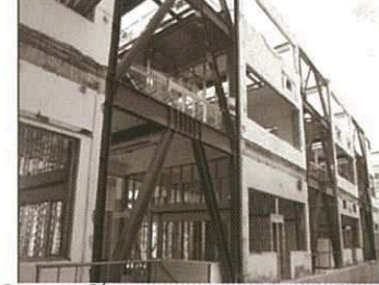
চিত্র ৩. পূর্ণবিন্যাস (Retrofitting) এর অংশ হিসাবে এই ভবনটিতে সারি করে ইস্পাতের বন্ধনী ঢোকানো হয়েছে।
